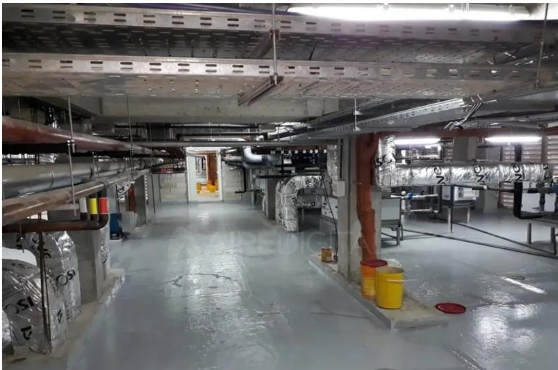
Fig. 13: Entrepiso técnico Hospital Iturraspe, Santa Fe –Argentina-. Mario Correa Aiello, arq.
